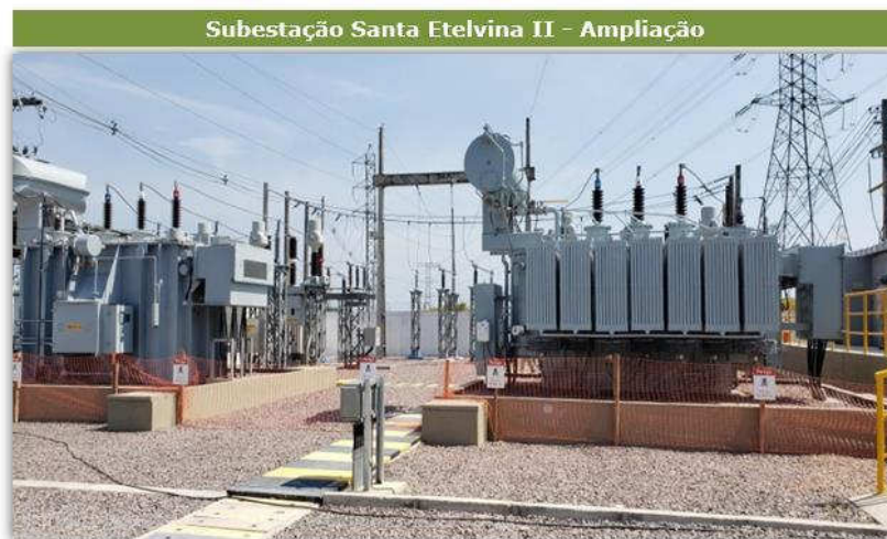
Ampliação de 52 MVA, 69kVA, Zona Norte de Manaus
