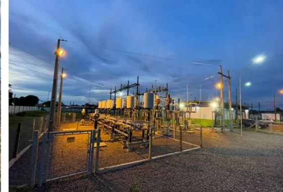
SE Manacapuru – etapa Implantação de Banco de Capacitores de 69 kV
