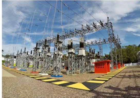
Ampliação da SE Redenção 69 kV - Seccionamento da linha de distribuição Ponta Negra Flores e Entrada de Linha na SE Redenção 69/13,8 kV
