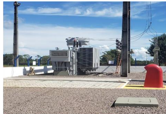
SE Iranduba substituição de transformador de 69/13,8 kV – 13,3 MVA por outro de 69/13,8 kV – 26,6 MVA.
