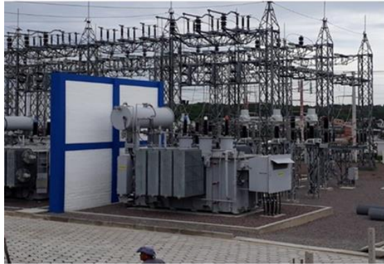
Ampliação da SE Distrito Dois 69 kV com a instalação do 5º transformador de 69/3,8
