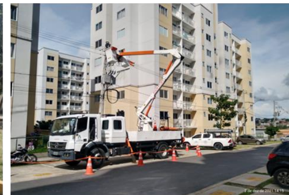
Interligação de Subestação Particular
