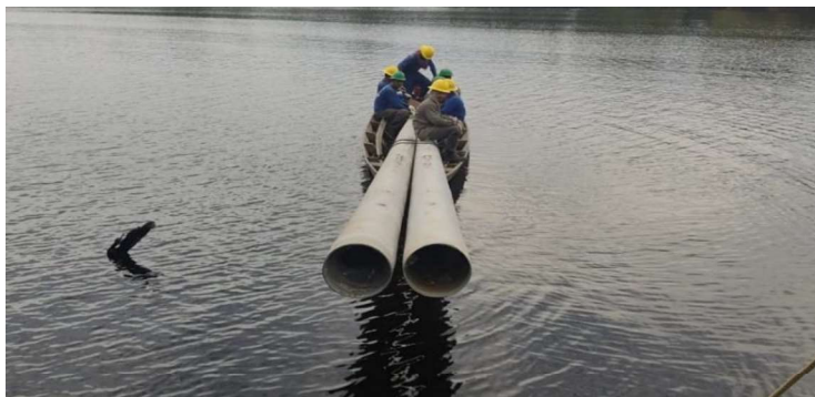
Na imagem, envio de postes para a comunidade de Aruxinim, no município de Borba.
