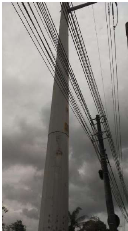
Figura 7. Ventania, fazendo a rede de média tensão encostar na rede de 69kV – área urbana.
