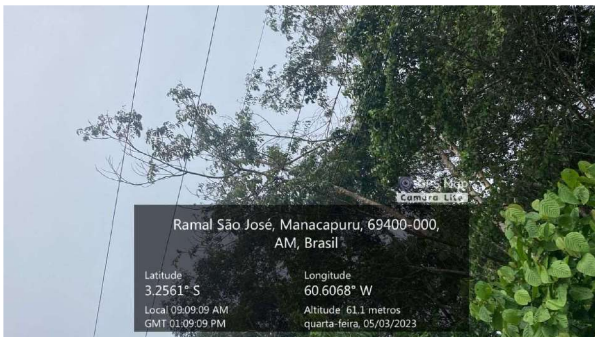
Figura 5. Árvore na rede de MT.
