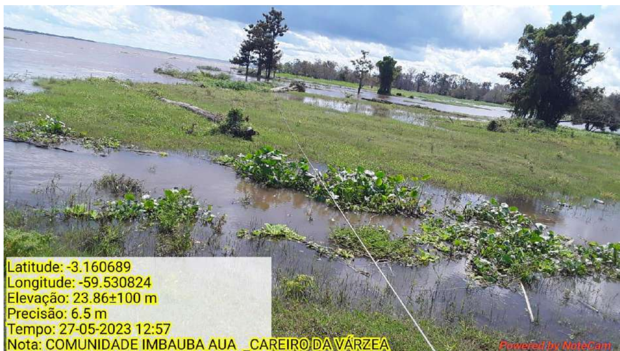
Figura 6. Cabo partido em região alagada.
