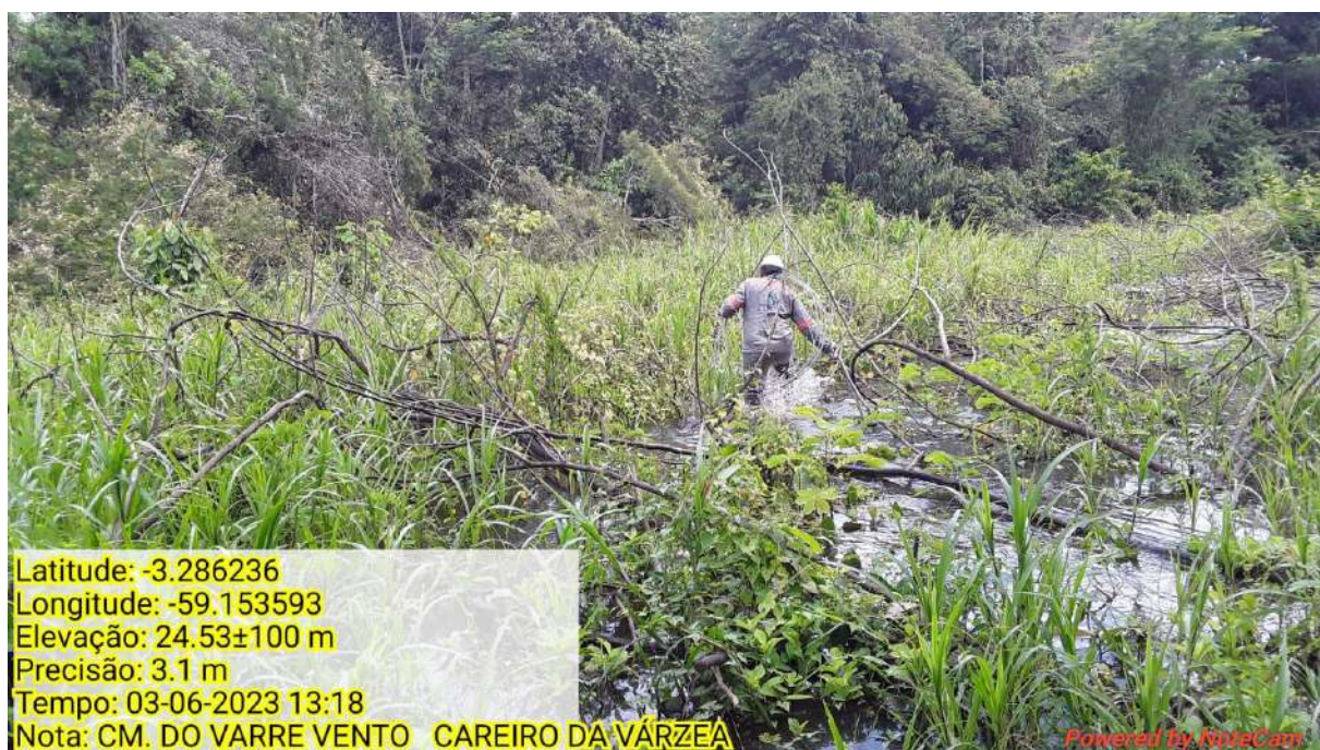
Figura 4. Rede de MT partida, em área alagada.
