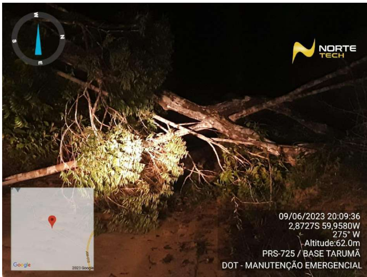
Figura 5. Árvore na rede de MT, ocasionando a quebra do poste.
