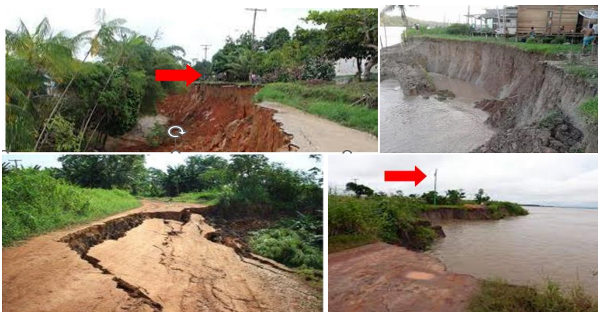
Figura 7 – Fenômeno terras caídas.
