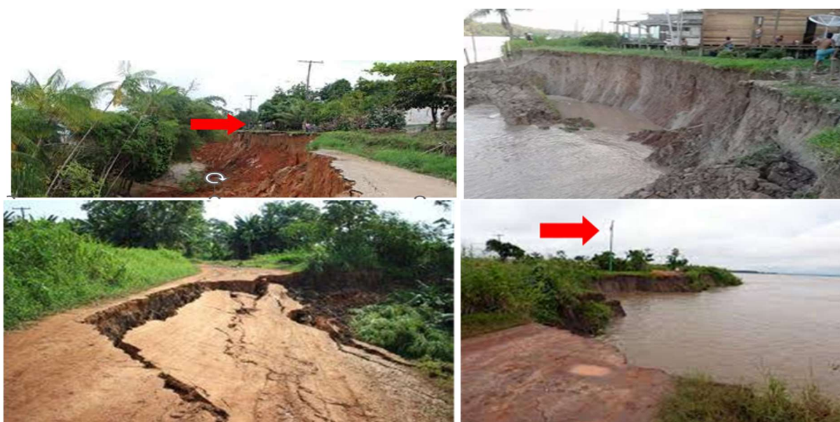
Figura 7 – Fenômeno terras caídas.
