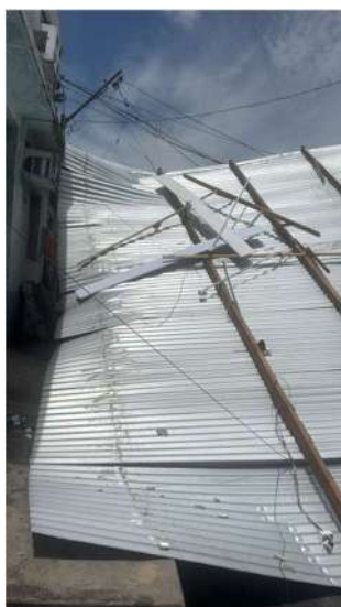
Figura 9. Rede comprometida devido à destelhamento durante temporal.
