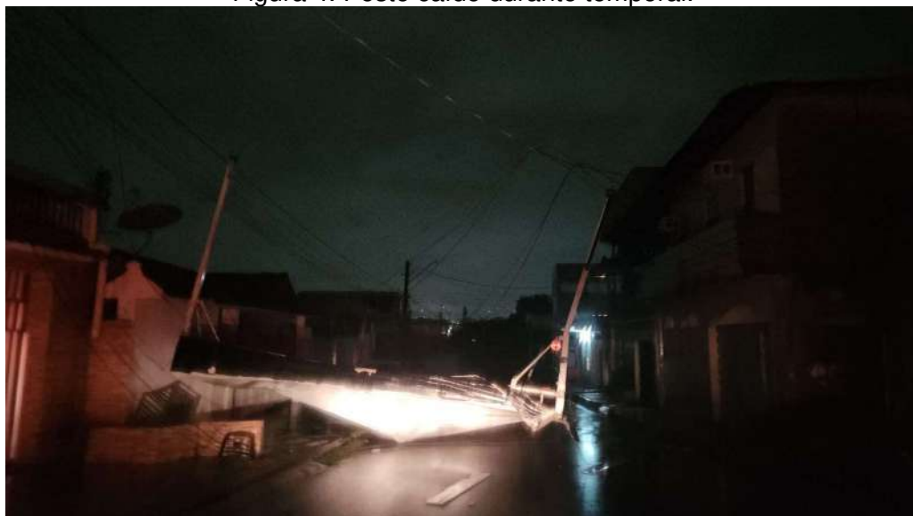
Figura 4. Poste caído durante temporal.
